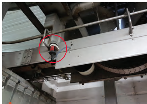
Kettenschmierung am Kastentransport zum Kastenausstoßer
