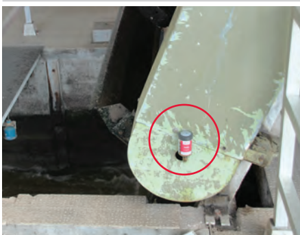
Wälzlagerschmierung am Grobrechen
