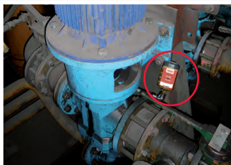
Schmierung einer Kraftstoffpumpe im Raffinerieprozess
