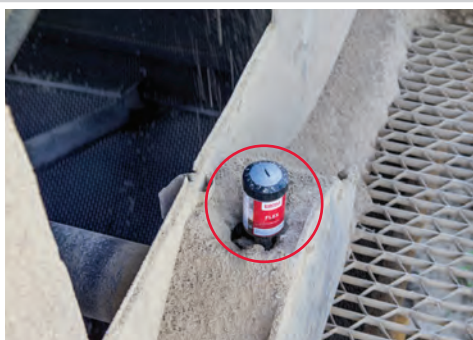
Stehlagerschmierung an Splitt- & Sandsieb
