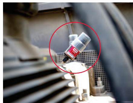
Lagerschmierung einer Lüfteranlage
