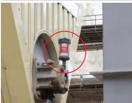
Flanschlagerschmierung an der Trogschnecke Entstaubung
