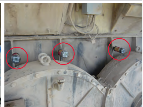
Schmierung einer Förderbandanlage
