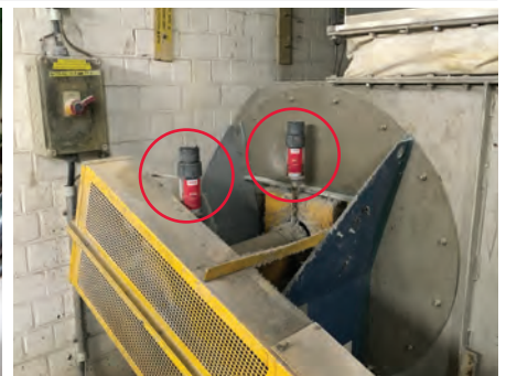
Lagerschmierung an einer Lüfteranlage
