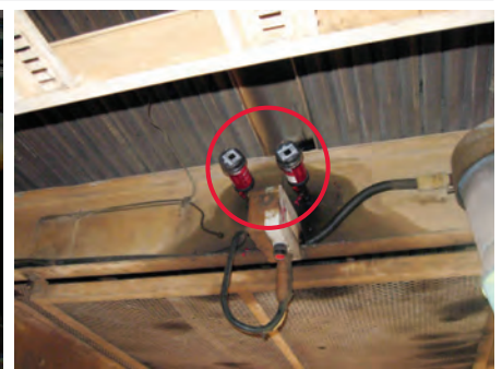
Schmierung des Lüfters (Fin Fan) einer Wärmetauscheranlage
