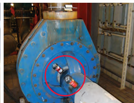
Antriebswellenschmierung einer Pumpe
