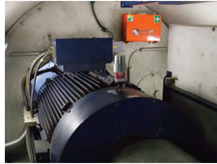
Automatische Nachschmierung der Generatorenlager
